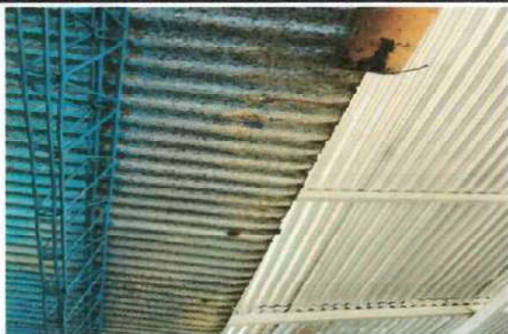
Foto 1: Deterioro de láminas del techo del establecimiento educativo
