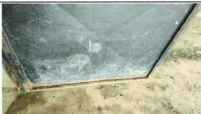
Foto 3: Puerta oxidada y difícil de cerrar
