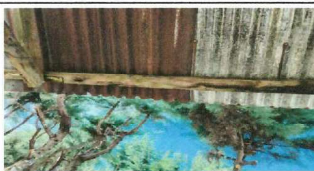
Foto 4: Techo de entrada principal oxidadas
