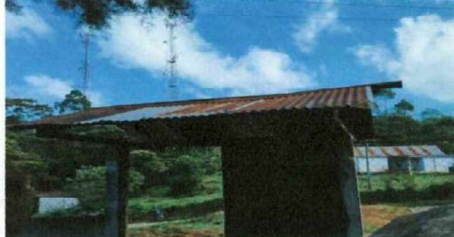
Foto 6: Porton en mal estado
